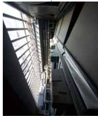
•面向百葉窗側的室外機
