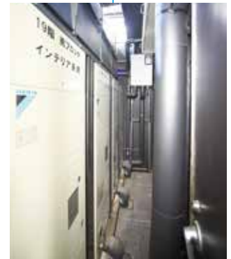
•面向室內側的室外機
