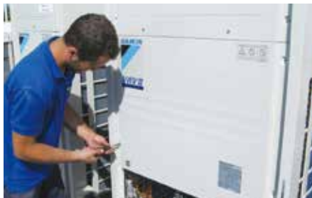
39 台 VRV III-Q 連結 215 台嵌入式室內機和 35 台 VAM 通風設備。
